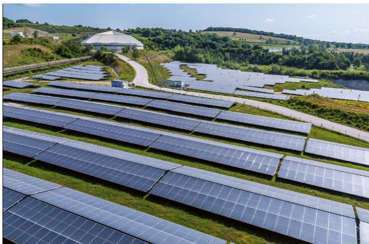
Elektrárne pozostáva z 9 030 fotovoltaických panelov s celkovým výkonom 5 MWp.
